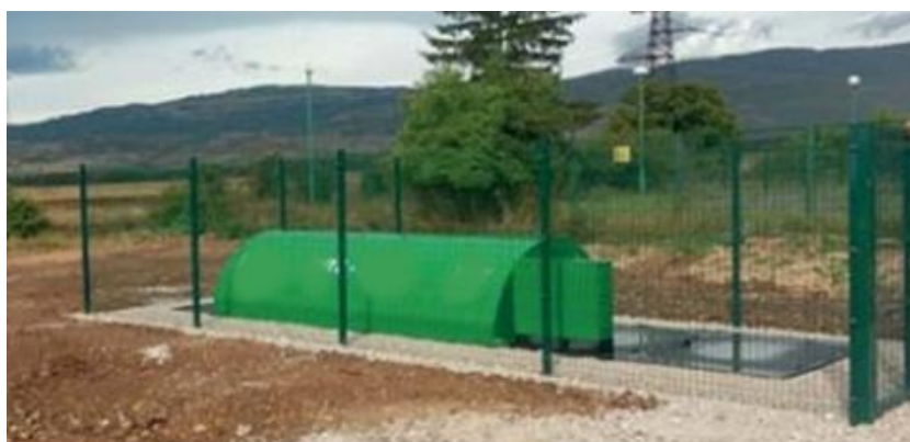
Slika 3.7. Primjer uređaja za pročišćavanje otpadnih voda koji je u funkciji
